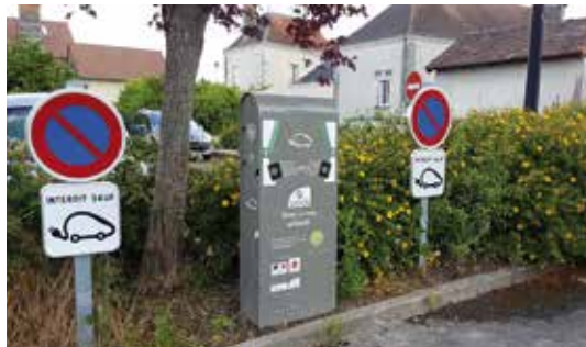
Borne de recharge Place Palousier
